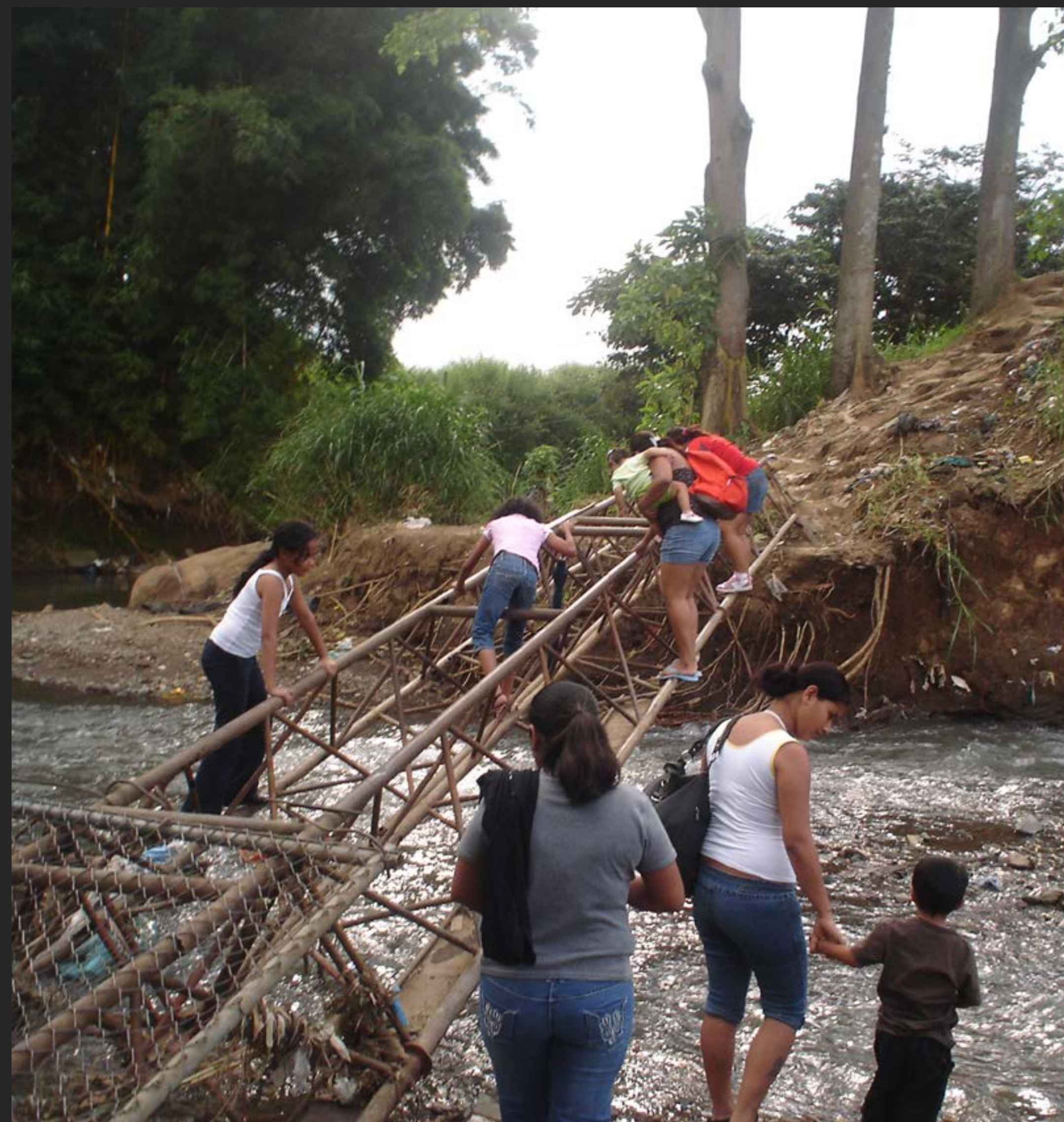
Ilustración N° 3 - Personas de la comunidad cruzando el río ante la caída del puente (2010)
